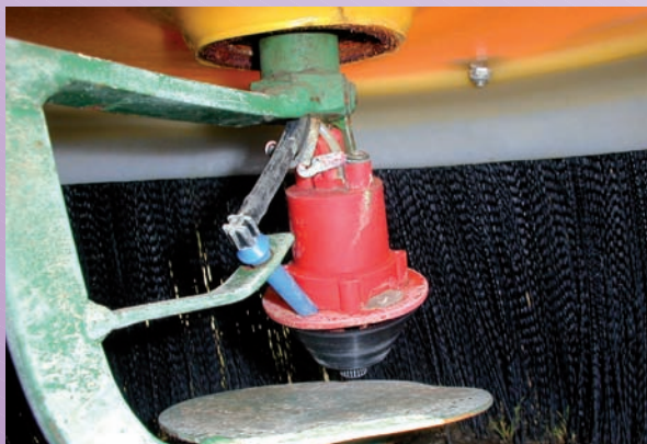
Détail et module de pulvérisation centrifuge
